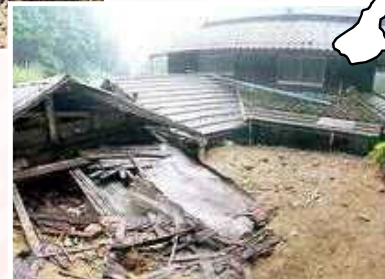
土石流による家屋の被害状況(朝来市佐養)
